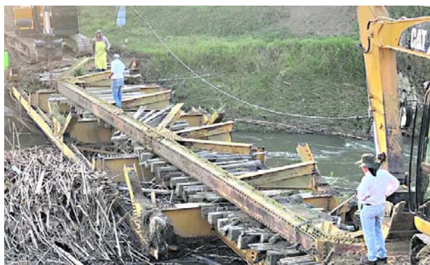
El puente se encontraba en mal estado y debió ser retirado.
