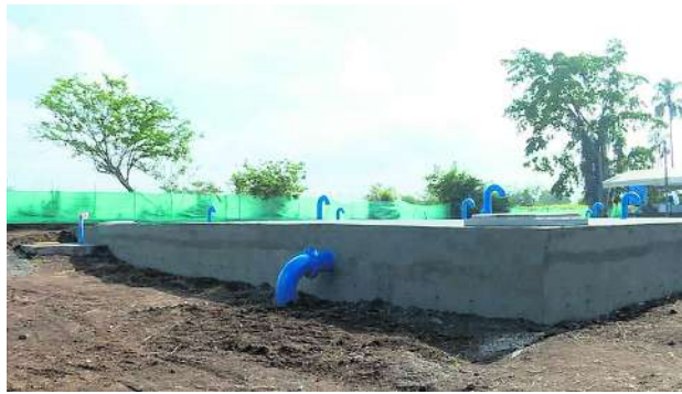
La construcción de nuevos tanques de almacenamiento en Bugalagrande y Andalucía mejorará el servicio de acueducto.
