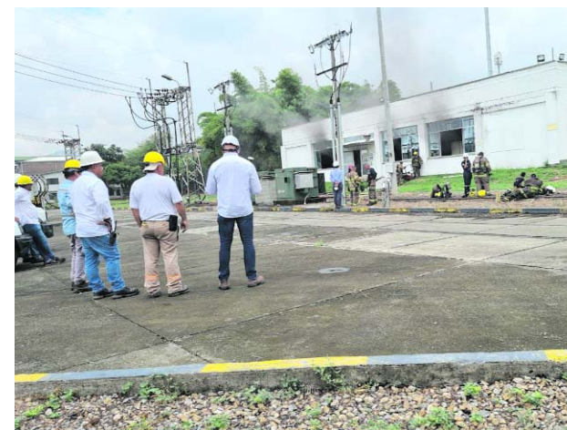
Ayer en la mañana se presentó un incendio en la subestación de energía de San Luis, que fue atendida por los bomberos.
