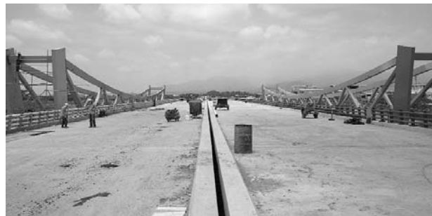
Uno de los puentes de los que se compone la prolongación de la Avenida Ciudad de Cali.
